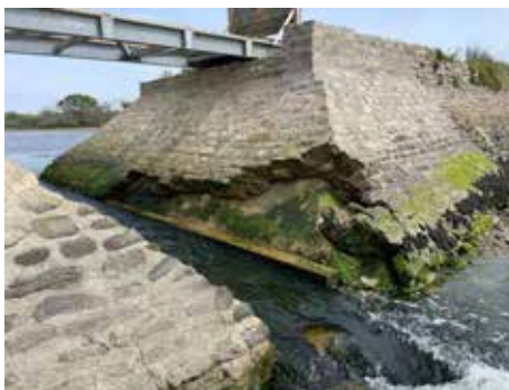
Le parement de pierre ne résiste pas à la force du courant dans le passage.
