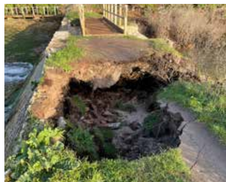
Cavité due à l'infiltration de l'eau apparue au droit du mur en béton réalisé pour soutenir la passerelle.
